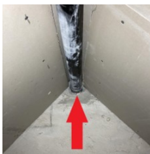
Tersløsevej 1, loft, brandvæg mod Tersløsevej 3.
