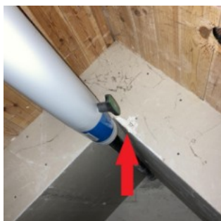
Tersløsevej 1, loft, skade på gipsbeklædning af brandkamserstatning.
