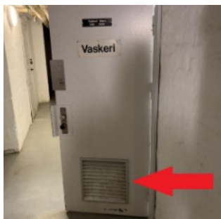
Tersløsevej 3, kælder, vaskeri, rist i dør.
