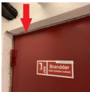
Frederikssundsvej 317B, kælder, varmecentral, dør mangler dørpumpe.
