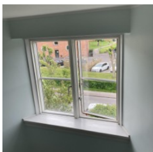
Trapperum, vinduer øverst, røgudluftning.
