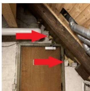
Glumsøvej 2, loft, væg over dør G02-00L er ikke intakt.
