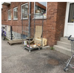
Træpaller og brændbart oplag op ad bygningen i gården.
